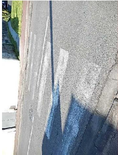
4 / Marquage à refaire Rue Charlevoix de Villiers
