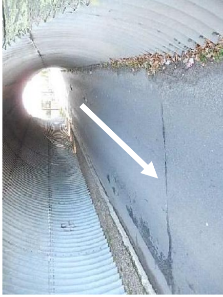
32 / Un trottoir de 90 cm en grave dans chaque tunnel Chaussée 300 cm Passages sous bid du Pyla
