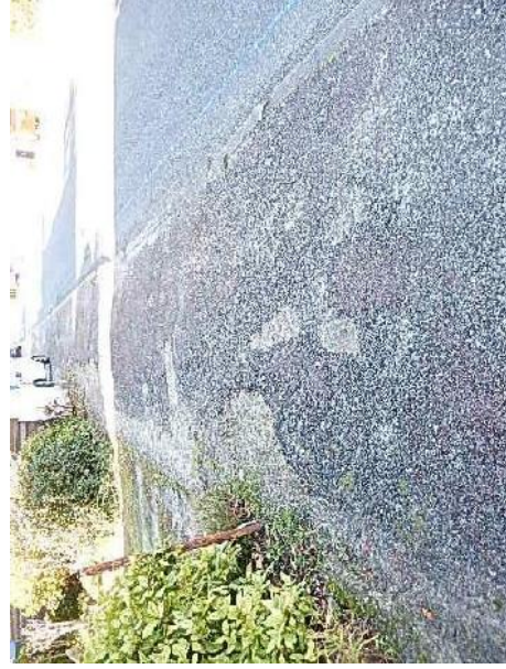
17 / Revêtement inconfortable ou détérioré Rue des Fusillés RD 112
