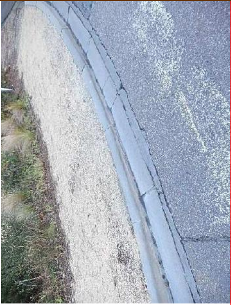
27 / Ressaut important sur l'abaissé Rue des Maraîchers
