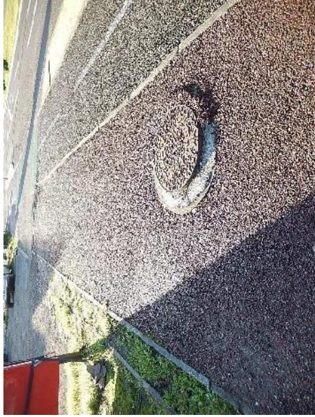
5 / Ressaut important Rue Lagrua
