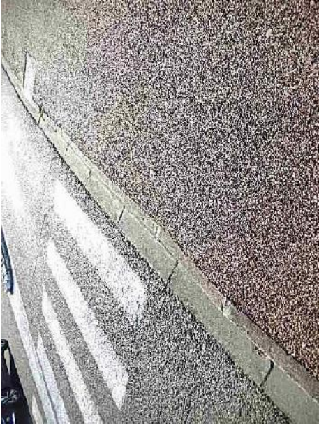
13 / Absence de bande d'éveil (BEV) Rue Lagrua
