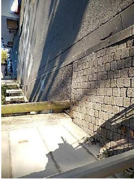
42 / Obstacle réduisant la largeur du trottoir Rue du général Castelnau
