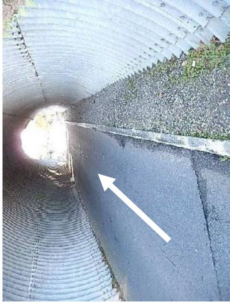
33 / Un trottoir de 90 cm en grave dans chaque tunnel Chaussée 300 cm Passages sous bid du Pyla
