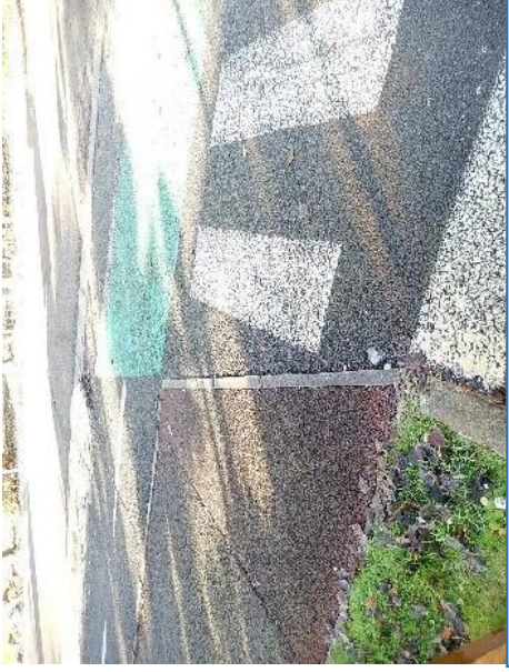
3 / Absence de bande d'éveil Rue Lagrua
