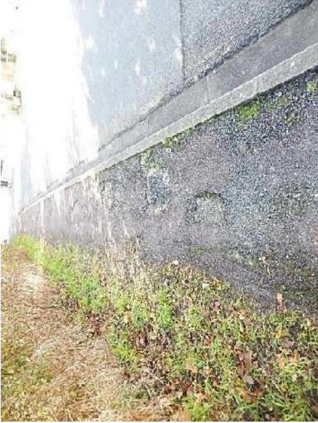
25 / Revêtement inconfortable ou détérioré Rue des Maraîchers
