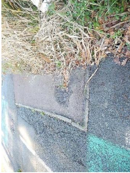
8 / Ressauts importants et végétation envahissante Rue Lagrua
